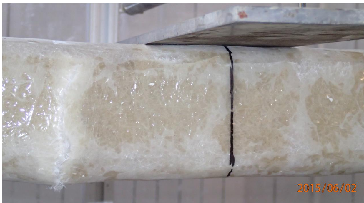
Fotografija 2.14 Prikaz pukotina
