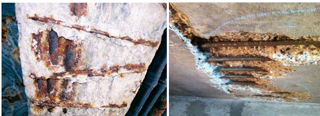
Slika 2.3. Primjeri oštećenja konstrukcije izazvanog korozijom armature
