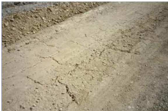
Slika 9.10 Pukotine u obliku „krokodilske kože“ na isušenju kruni nasipa
