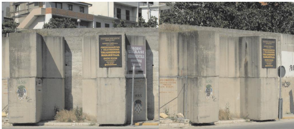
Slika 3.9 Betonski blokovi kao podupore nestabilnom konzolnom zidu (dokumentacija autora)
