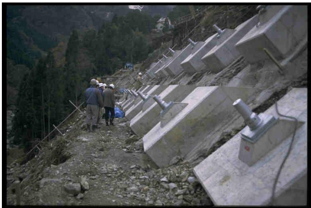
Slika 7.2 Sidreni blokovi i glave niza sidara, otok Tokushima, Japan ( www.kingston.ac.uk )
