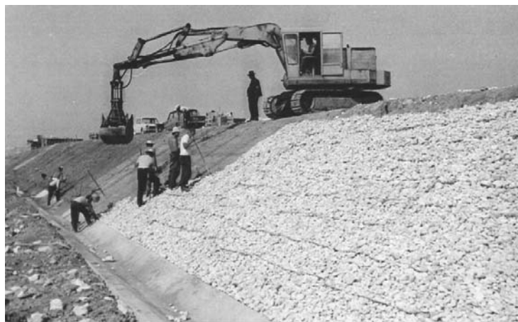
Slika 14.22 Zaštita pokosa gabionima punjenim kamenom (Miščević), zamjenjuju roliranje kamenom
