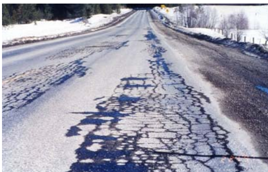
Slika 7.1 Oštećenja kolnika nakon otapanja leća leda
