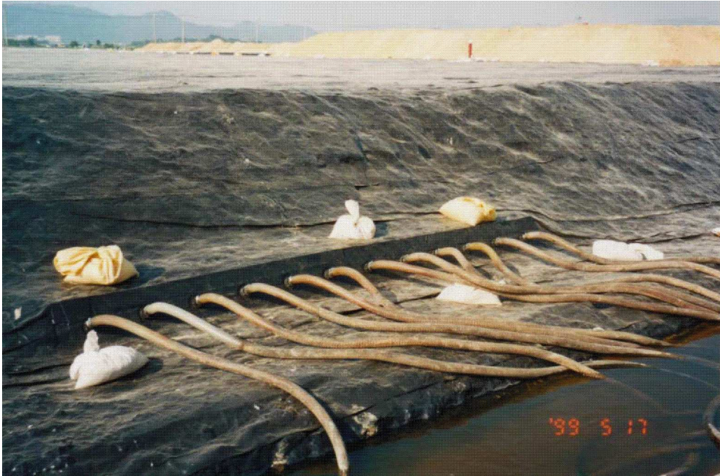
Slika 9.64 Detalj izlaza cijevi ispod nepropusne membrane
