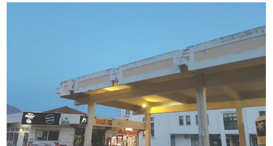
_loše stanje postojeće strehe kolodvora
