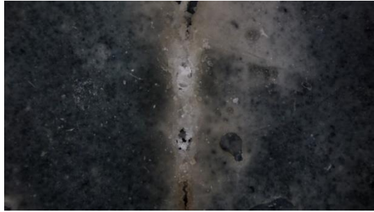
Slika 38. Stanje pukotine nakon 56 dana [86]
