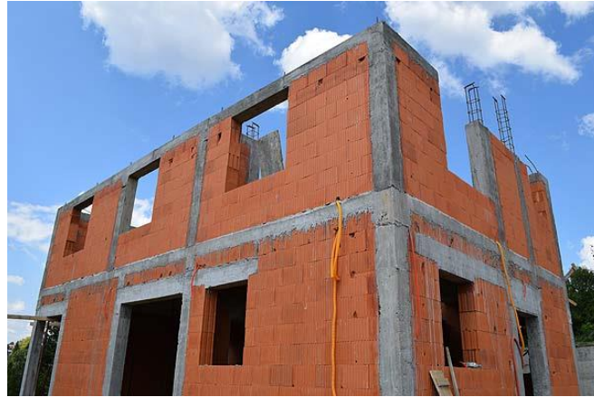
Slika 6.64 – Nadvoj u zidanom zidu
