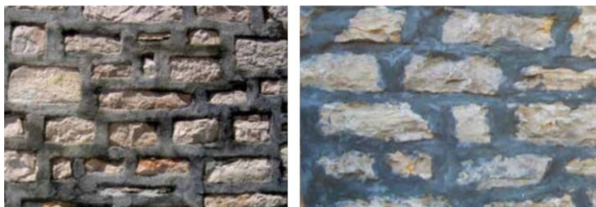
Slika br.10 Neispravni načini fugiranja [1]
