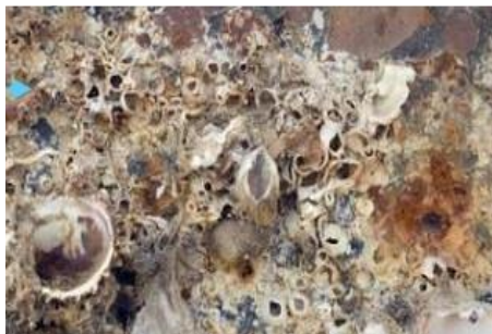
Slika 2.5 Školjke na betonu
