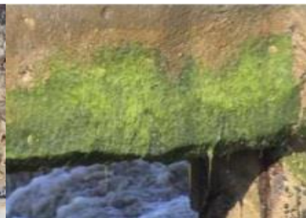
Slika 2.6 Alge na betonu
