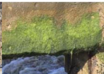
Slika 2.6 Alge na betonu
