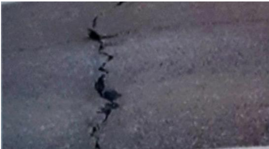
Slika 20. Izgled pukotine uzrokovane toplinskim skupljanjem [5]
