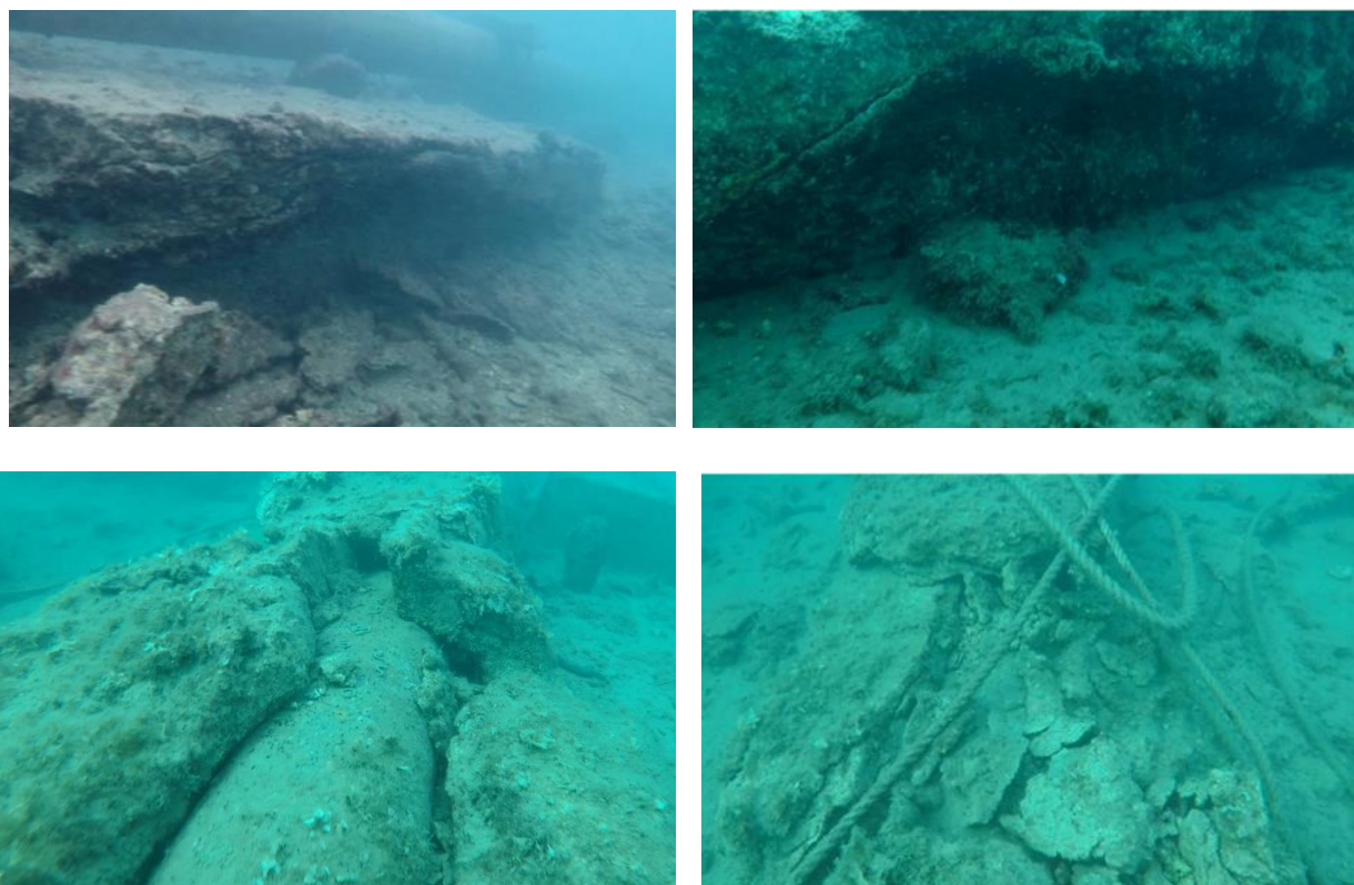
Slike 1.-4. Prikaz oštećenja postojeće betonske zaštite
