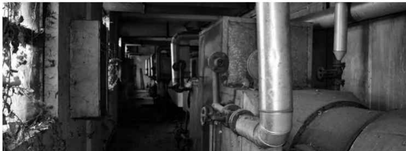
Sustav ventilacije ferkomora stanice Stolac
