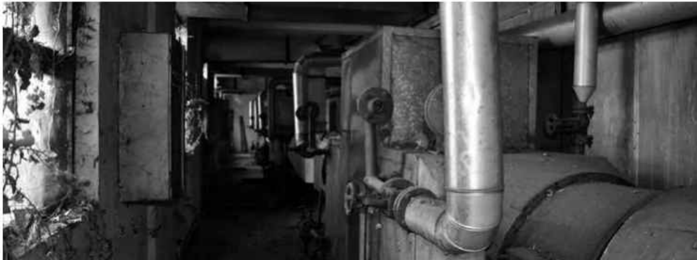
Sustav ventilacije fermkomora stanice Stolac
