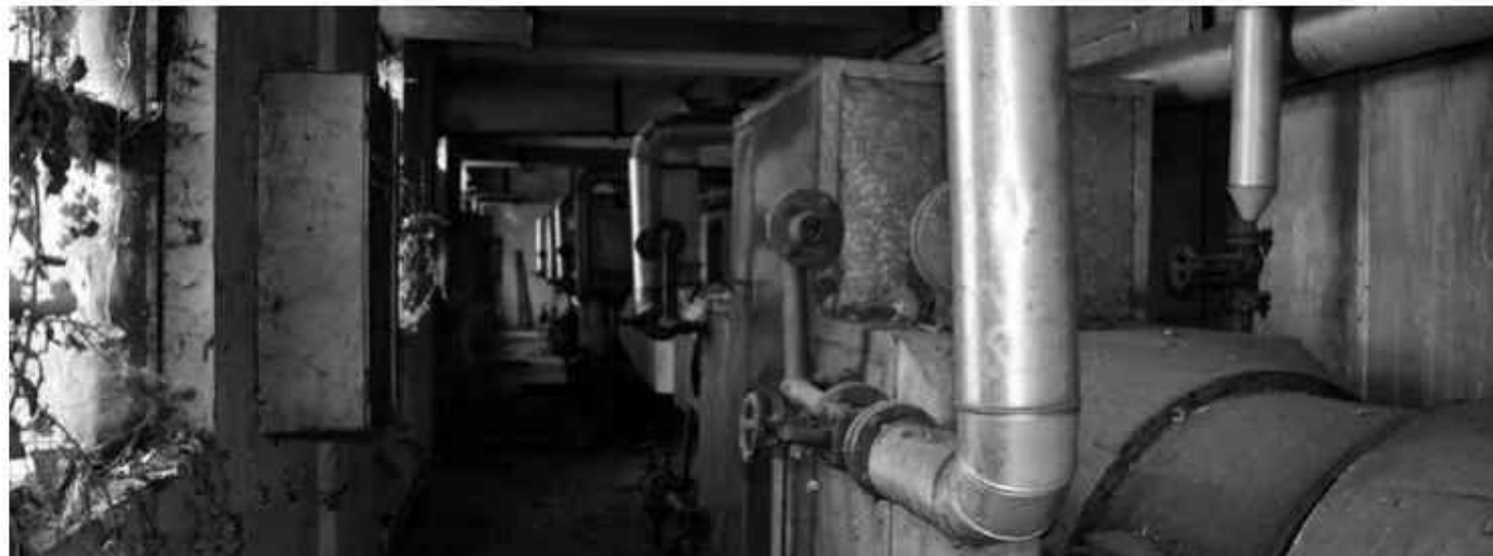
Sustav ventilacije ferkomora stanice Stolac
