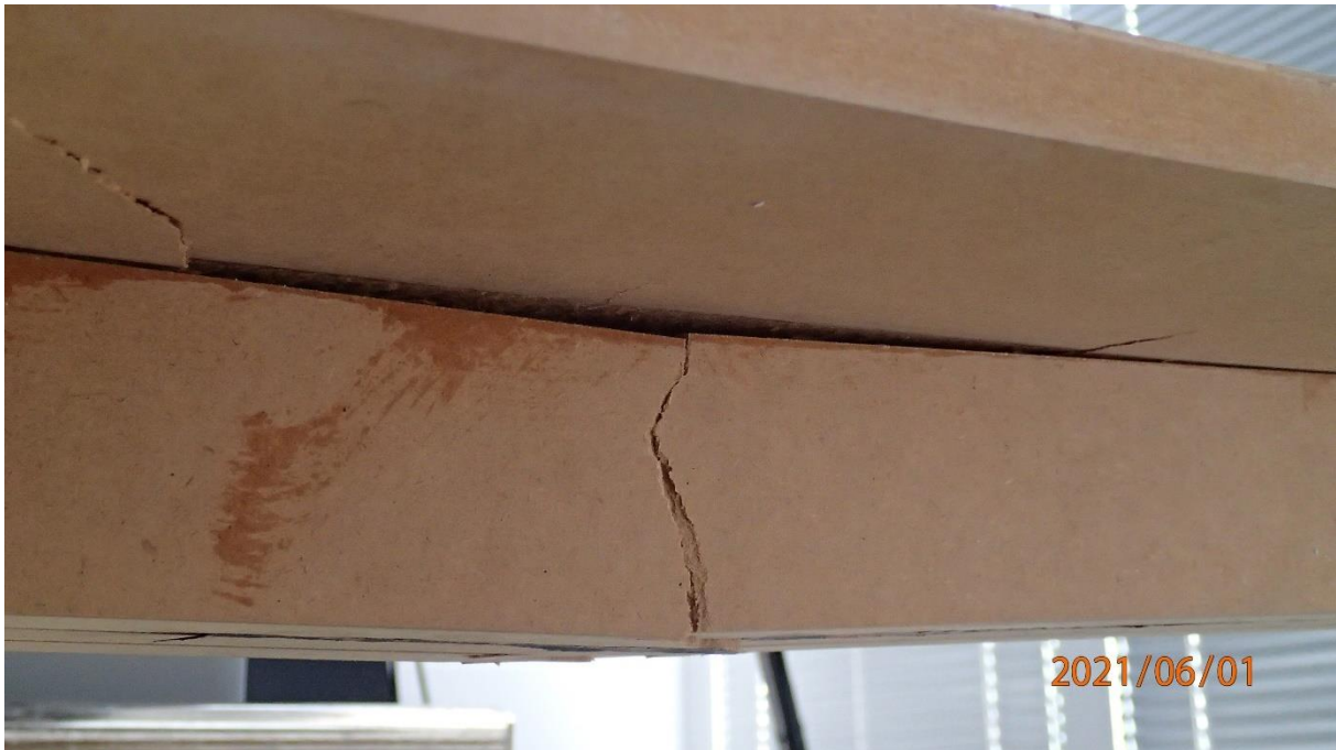
Slika 65: Pukotine nosača na unutarnjem licu poprečnog presjeka nosača
