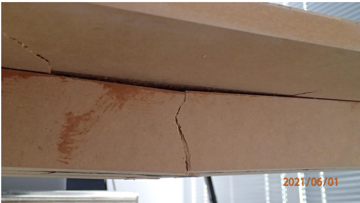
Slika 65: Pukotine nosača na unutarnjem licu poprečnog presjeka nosača
