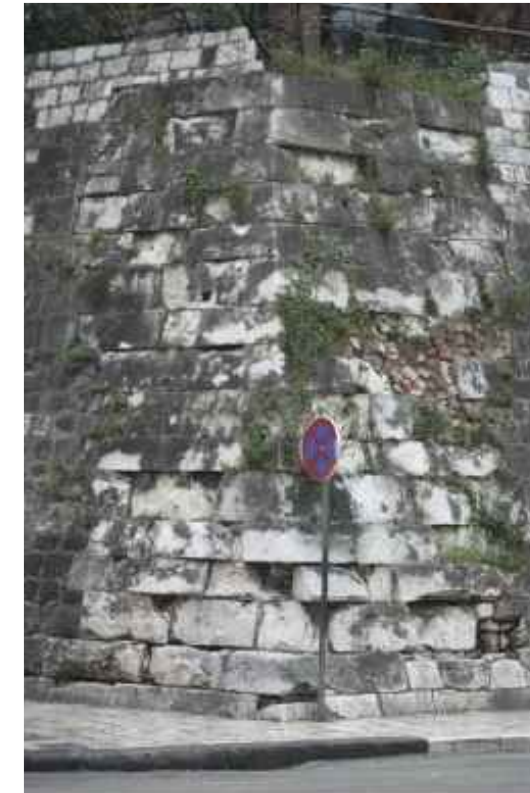
_29 Oštećenje lica bedema
