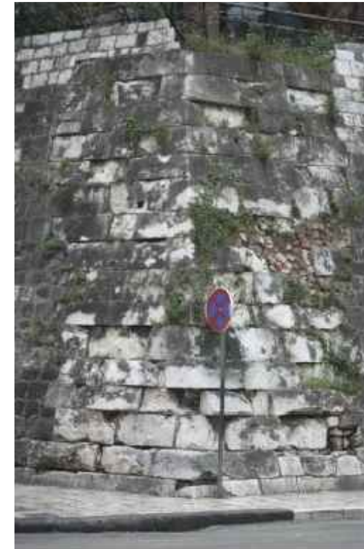
_29 Oštećenje lica bedema
