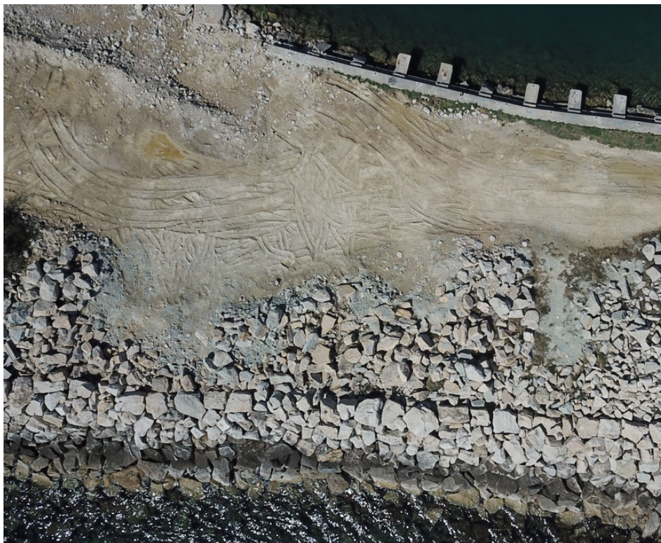
Slika 8.1.3. Postojeći lukobran s brojnim vidljivim oštećenjima
