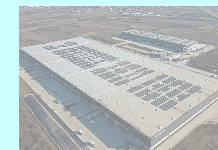
SOLARNE PLOČE NA KROVU
