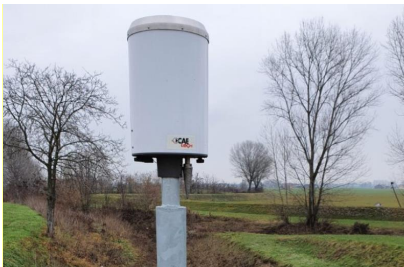
Slika 5. Primjer pluviometra postavljenog na otvorenom prostoru [11]
