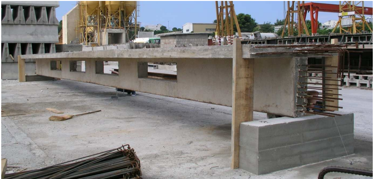
Slika 2.1. Pogled na predgotovljeni montažni nosač
