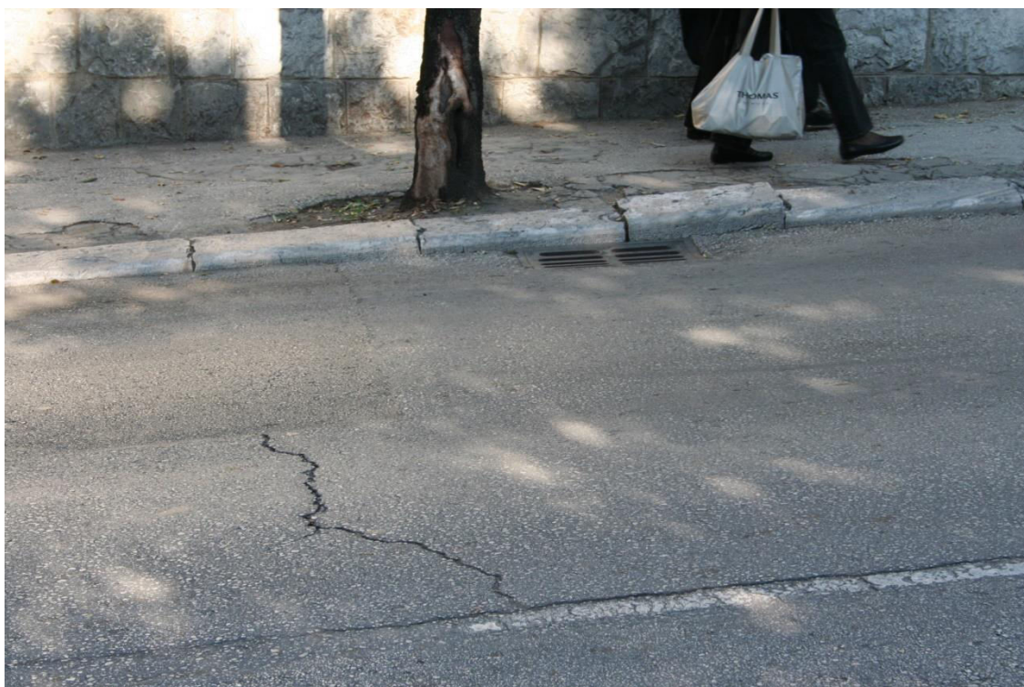
Slika 7. Vukovarska Ulica (oštećenja sjevernog rubnjaka)
