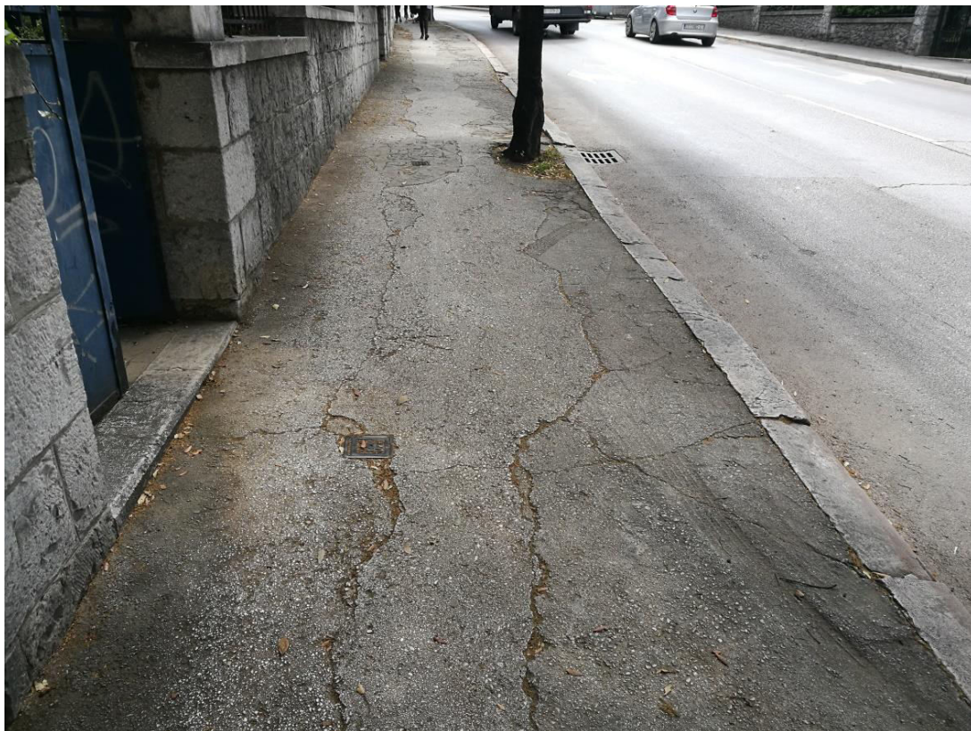
Slika 6. Vukovarska Ulica (oštećenja sjevernog pločnika)
