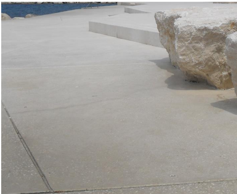
Slika 7.13. Pukotina na plaži Monte Mulini
