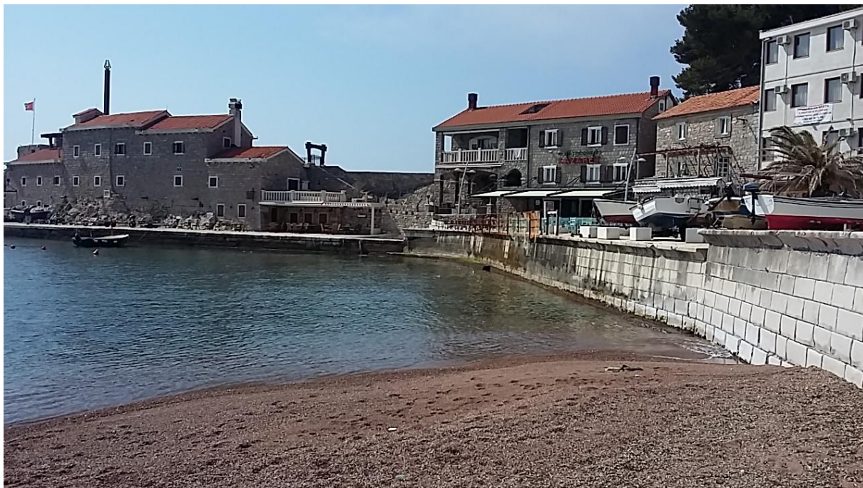
Slika 5.1 Stanje obalnog zida i gata na zapadnom rubu plaže Petrovac 25.03.2017.
