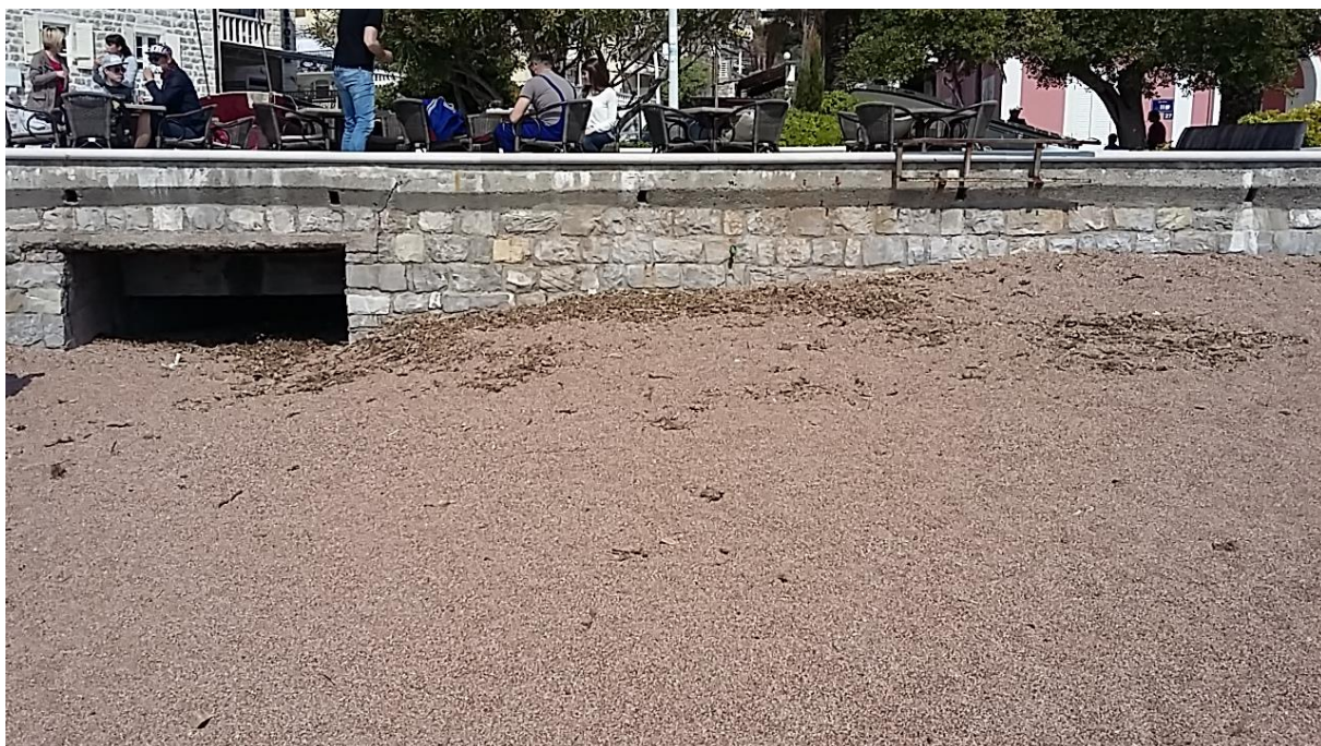
Slika 5.2 Stanje obalnog zida i bujični kanal 50 m od zapadnog ruba plaže Petrovac 25.03.2017.
