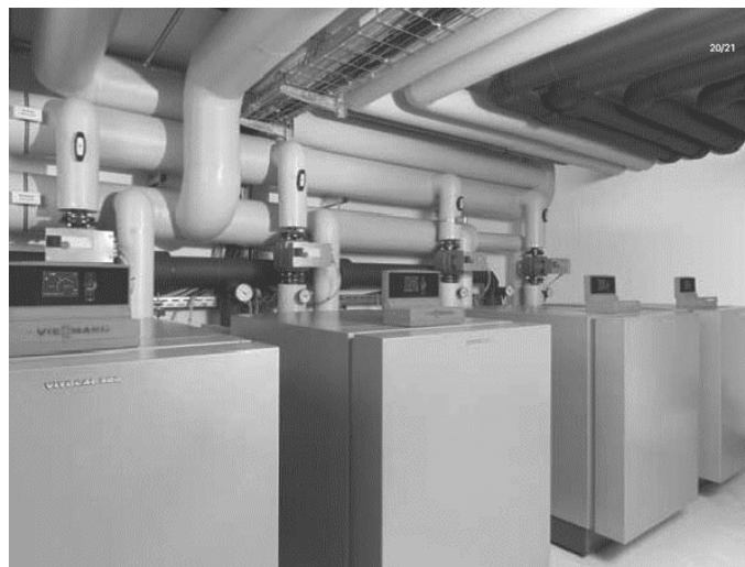
toplinske pumpe u podrumu
