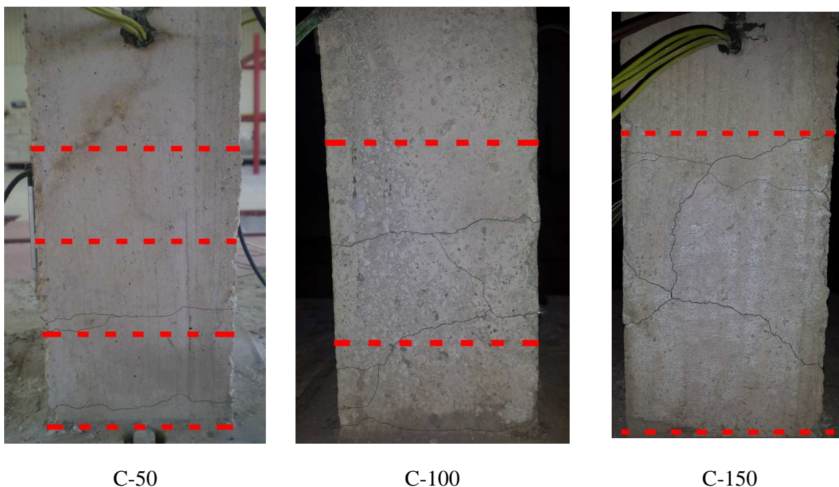
Slika 3.65 Izgled stupova pri dnu nakon završenog testiranja
