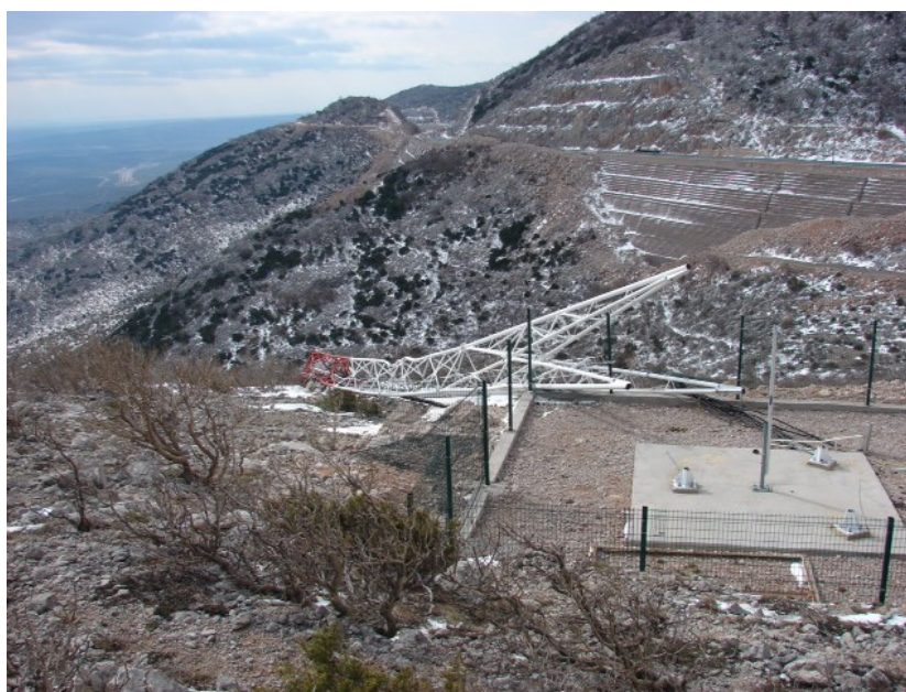
Slika 5.1 Srušeni antenski stup, Marune (južna padina Velebita, 2013)
