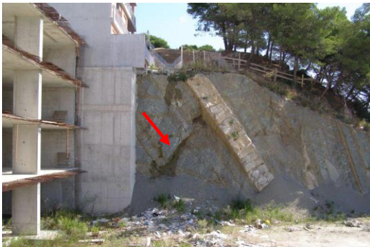
(c) 2006. (procjeđivanje kroz sekundarne pukotine)
