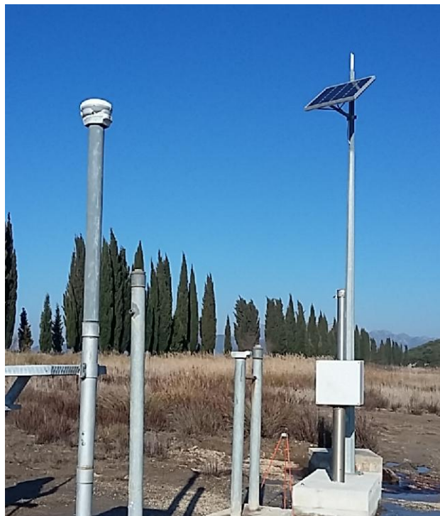
Slika 1.6. Plitki i duboki pijezometri na Lokaciji 1 – nasip Diga
