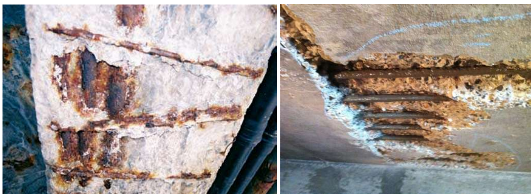
Slika 2.3. Primjeri oštećenja konstrukcije izazvanog korozijom armature
