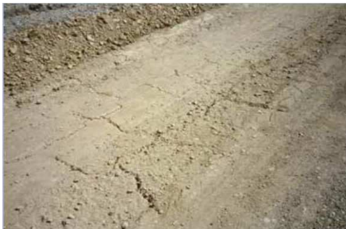
Slika 9.10 Pukotine u obliku „krokodilske kože“ na isušenj kruni nasipa
