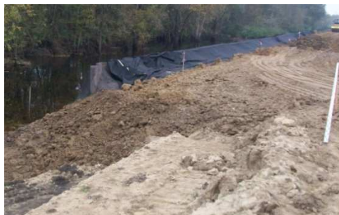
Slika 6.29 Ugradnja čeličnog (Larsen) žmurja i geotekstila pri sanaciji nasipa u Istočnoj Slavoniji 2014.
