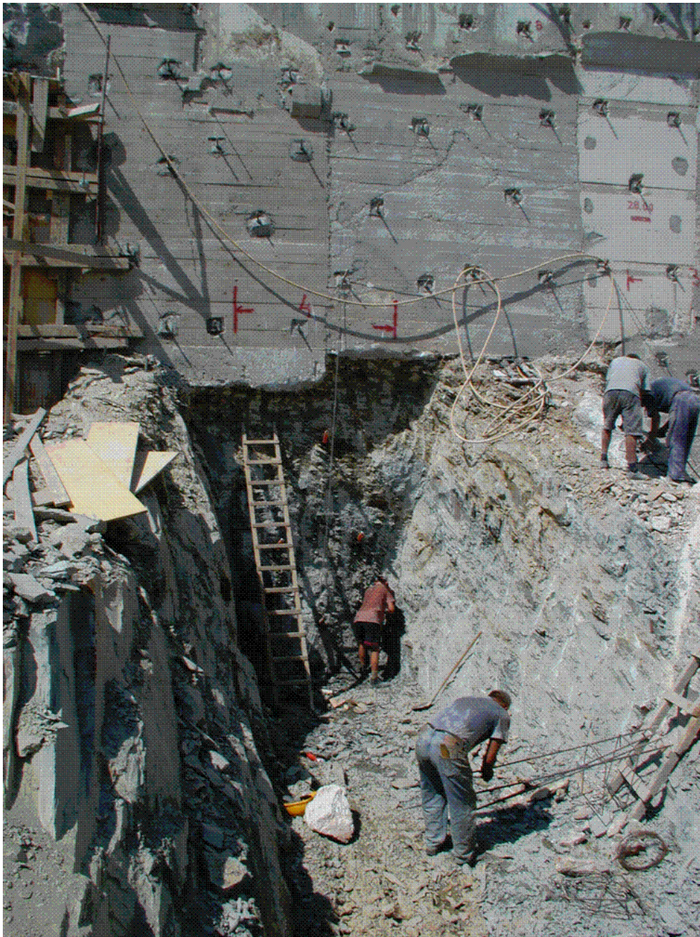
Slika 7.29 Tipična sidrena građevina koja se postepeno spušta, sastoji se od armiranobetonskog platna i niza sidara (snimio Ž. Reljanović)
