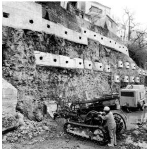
Slika 14.6 Zaštita pokosa usjeka u stijeni sidrima i veznim gredama (Mišćević)
