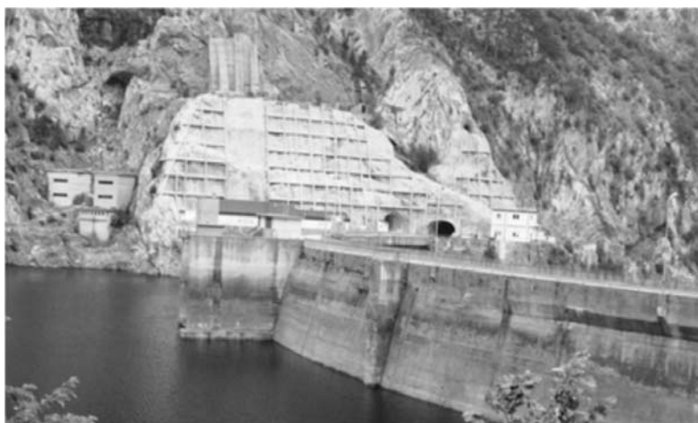
Slika 14.8 Zaštita pokosa zasjeka u lijevom boku brane Mratinje (Crna Gora) u okršenim vapnencima, armirano-betonskim roštiljem i sidrima
