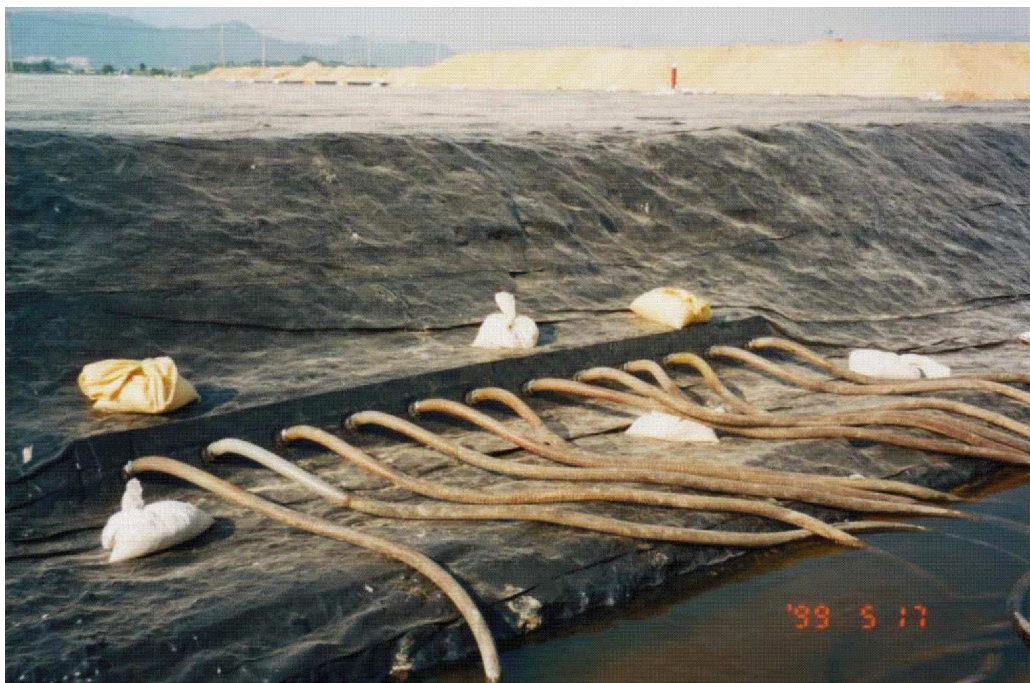
Slika 9.64 Detalj izlaza cijevi ispod nepropusne membrane
