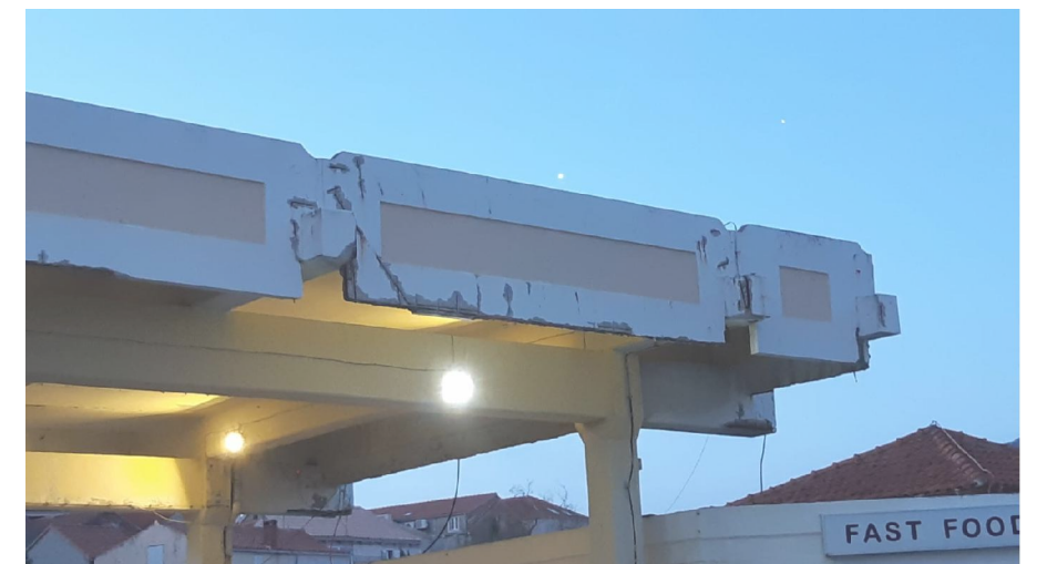
_loše stanje postojeće strehe kolodvora
