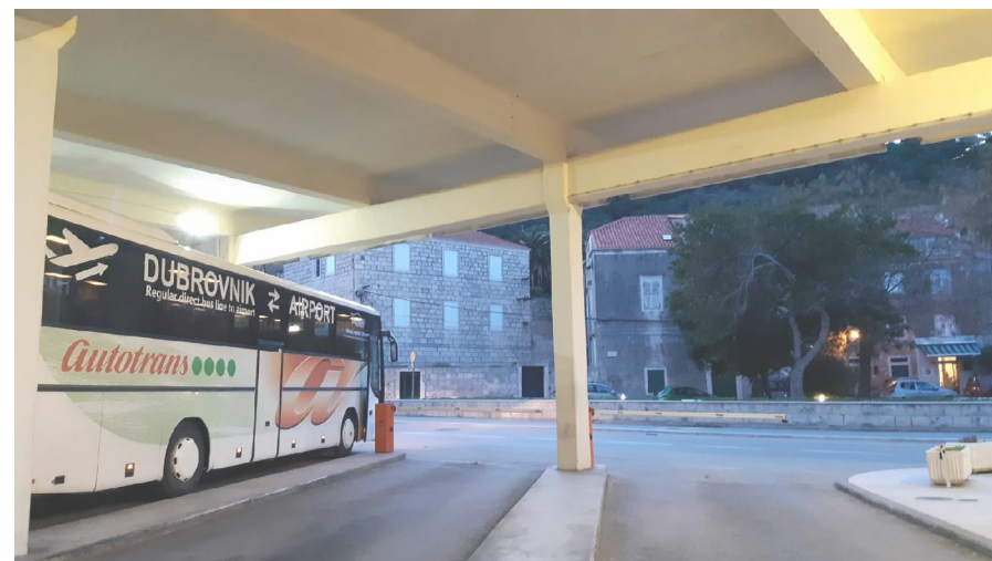
_peroni s neadekvatnim prostorom za iskrcaj i ukrcaj
