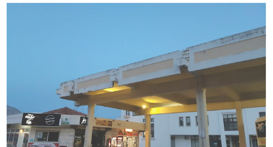
_loše stanje postojeće strehe kolodvora
