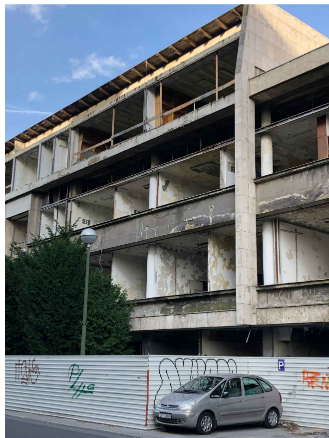
▲ ZATEČENO STANJE ZAPADNE FASADE
