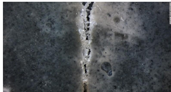
Slika 37. Stanje pukotine nakon 28 dana [86]
