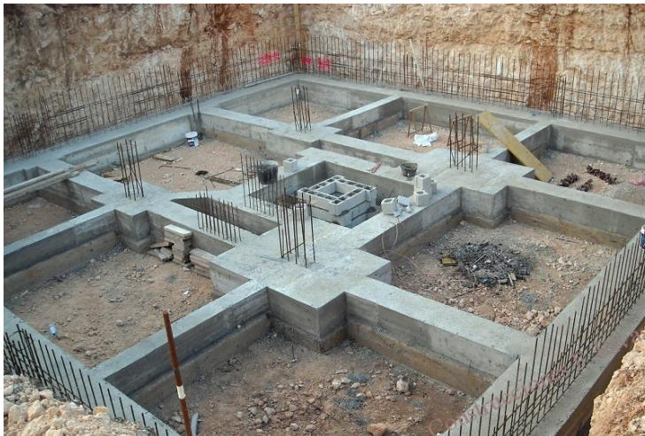
Slika 6.102 – Temelji samci ispod stupova i temeljne trake ispod zidova - temelji samci povezani temeljnim gredama
