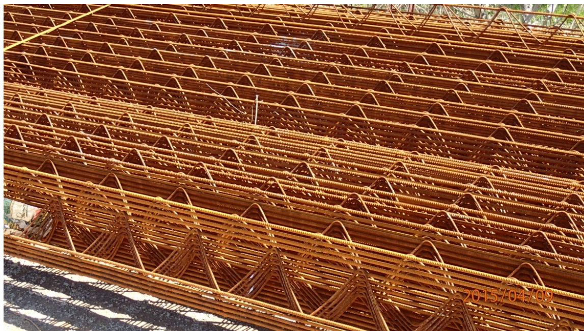
Foto 4.2: Armaturne šipke gredica
