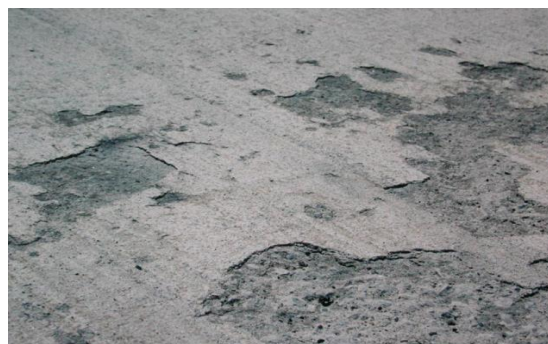
Slika 3.3 Oštećenje betona zbog smrzavanja [10]
