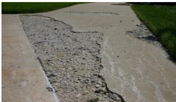
Slika 3.3 Oštećenje betona zbog smrzavanja [10]
