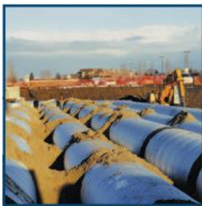
Slika 4.8 Prikaz valovitih čeličnih cijevi i sustava
