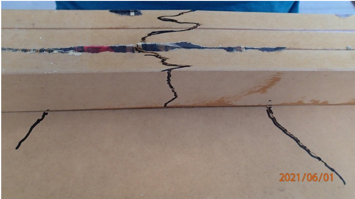
Slika 66: Pukotine s donje strane nosača
