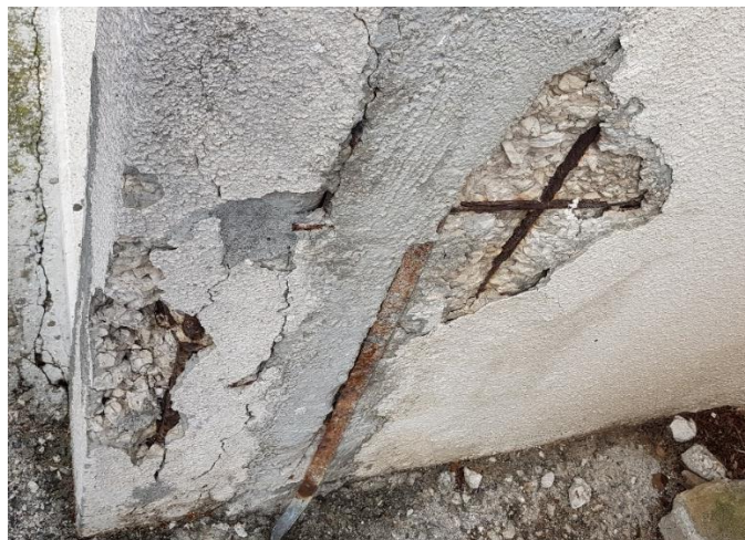
Slika 8. Problemi uslijed nedostatka zaštitnog sloja
