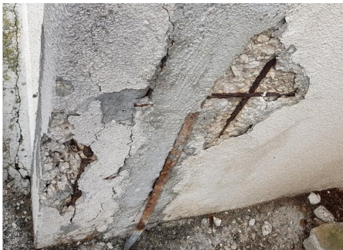
Slika 8. Problemi uslijed nedostatka zaštitnog sloja
