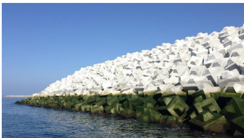
Slika 4.7.2. Pokos trupa lukobrana s Cubipod primarnom zaštitom
