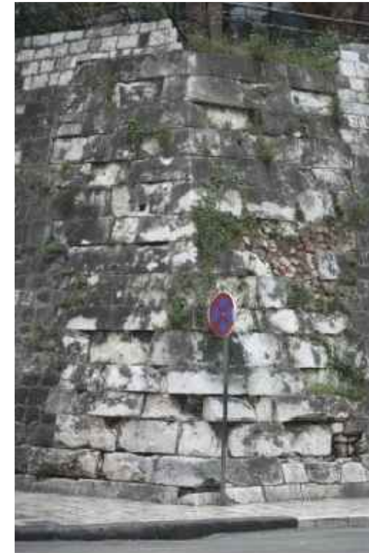
_29 Oštećenje lica bedema
