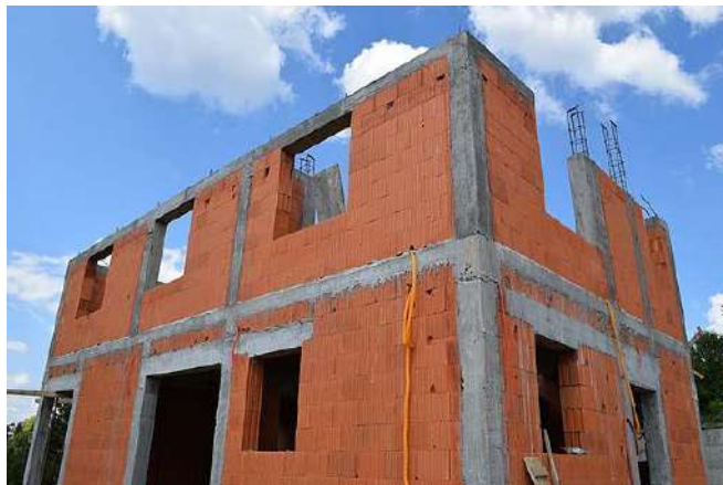
Slika 6.63 – Nadvoj u zidanom zidu
