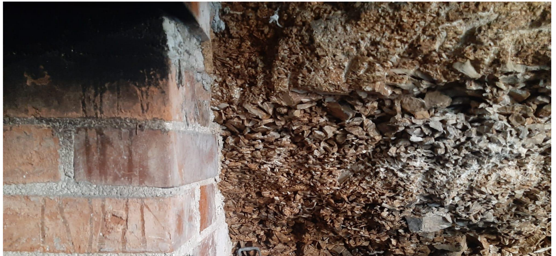
Slika 21: detalj spoja opeke s hrpaćušom
