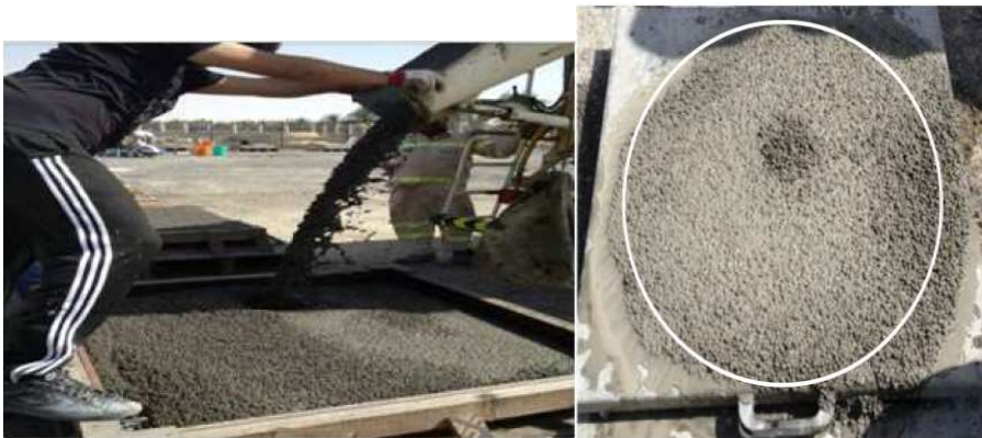
Slika 5.10: a) izlivanje betona na mjestu ugradnje (lijevo); b) rasprostiranje slijeganjem-ispitivanje na terenu (desno)[17]
