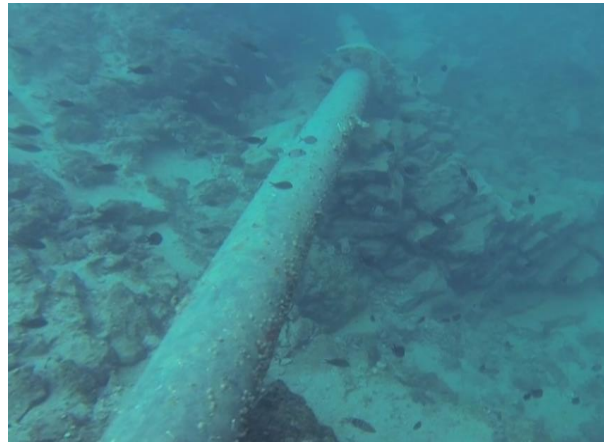
Slika 18. Vertikalni i horizontalni lom cjevovoda
