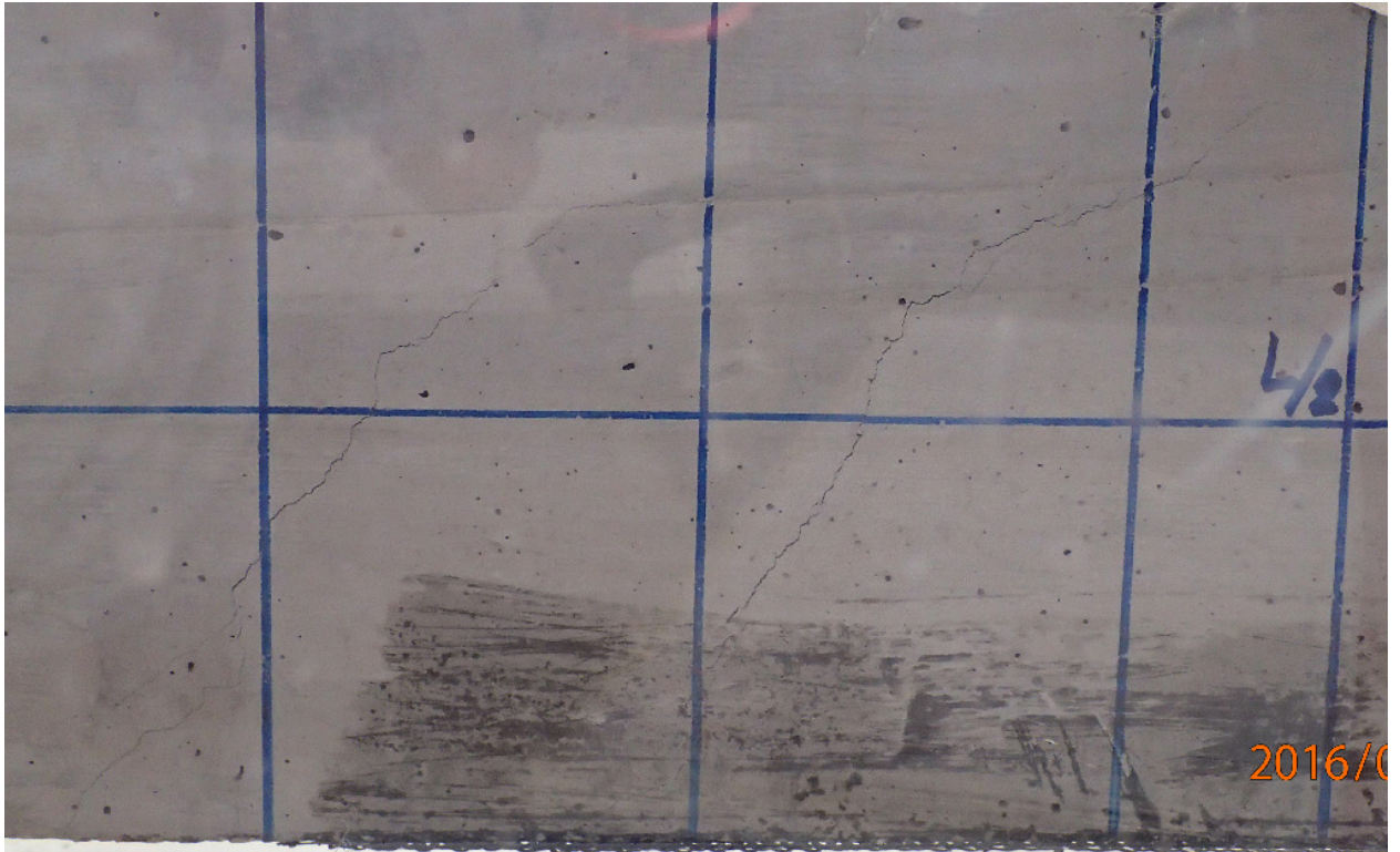
Fotografija 4.19. Pojava pukotina na gredi G3(ojačana karbonskom trakom duljine 50 cm)
