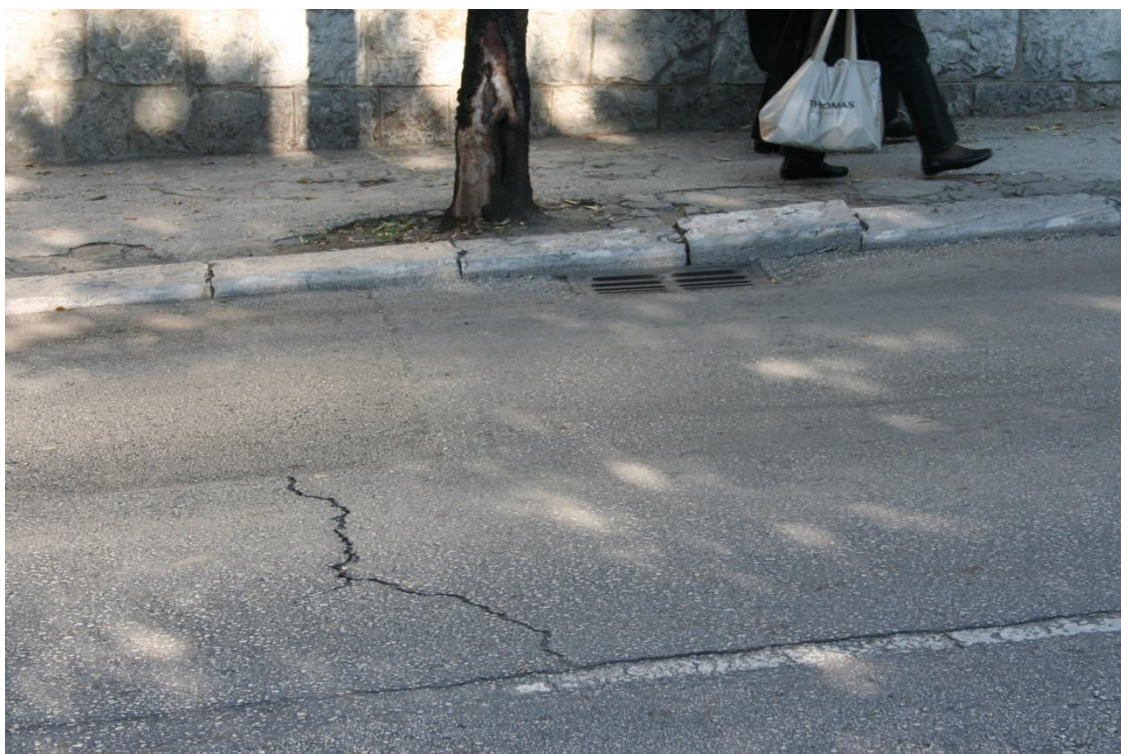
Slika 7. Vukovarska Ulica (oštećenja sjevernog rubnjaka)
