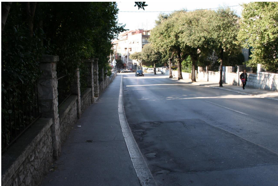
Slika 5 . Vukovarska Ulica (loše stanje kolnika)
